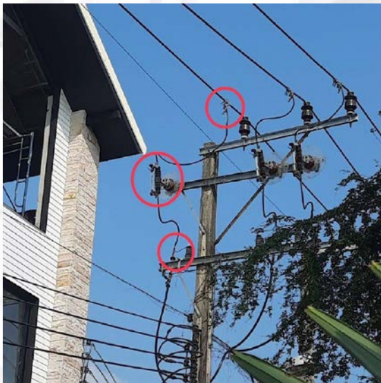
ภาพที่ ๔ จุดเสี่ยง ๓ จุด ที่สามารถทำให้เกิดกระแสไฟฟ้าดูดได้
