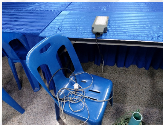
รูปคอมไฟส่องสว่างที่ใช้
