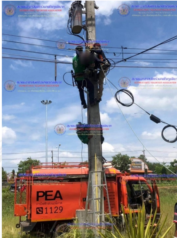
รูปภาพที่ ๗ แสดงบริเวณพื้นที่การทำงานที่ลูกจ้างเสียชีวิตในวันที่เกิดเหตุ
