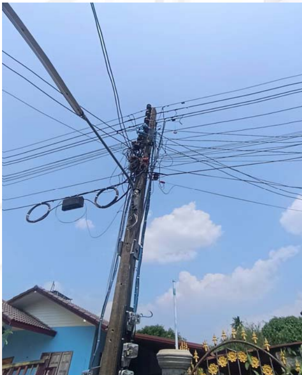
เสาไฟฟ้ามีสายไฟฟ้าและสายสื่อสารจำนวนมาก
