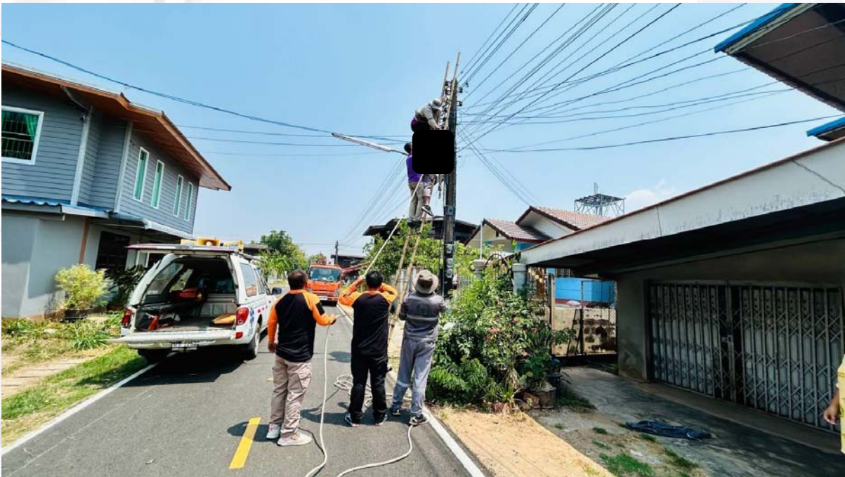
รูปถ่ายแสดงเหตุการณ์ลูกจ้างถูกกระแสไฟฟ้าดูด
