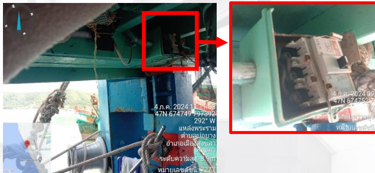
ภาพที่ ๑ จุดติดตั้งเบรกเกอร์ บริเวณด้านในหลังคาแกงเรือ
