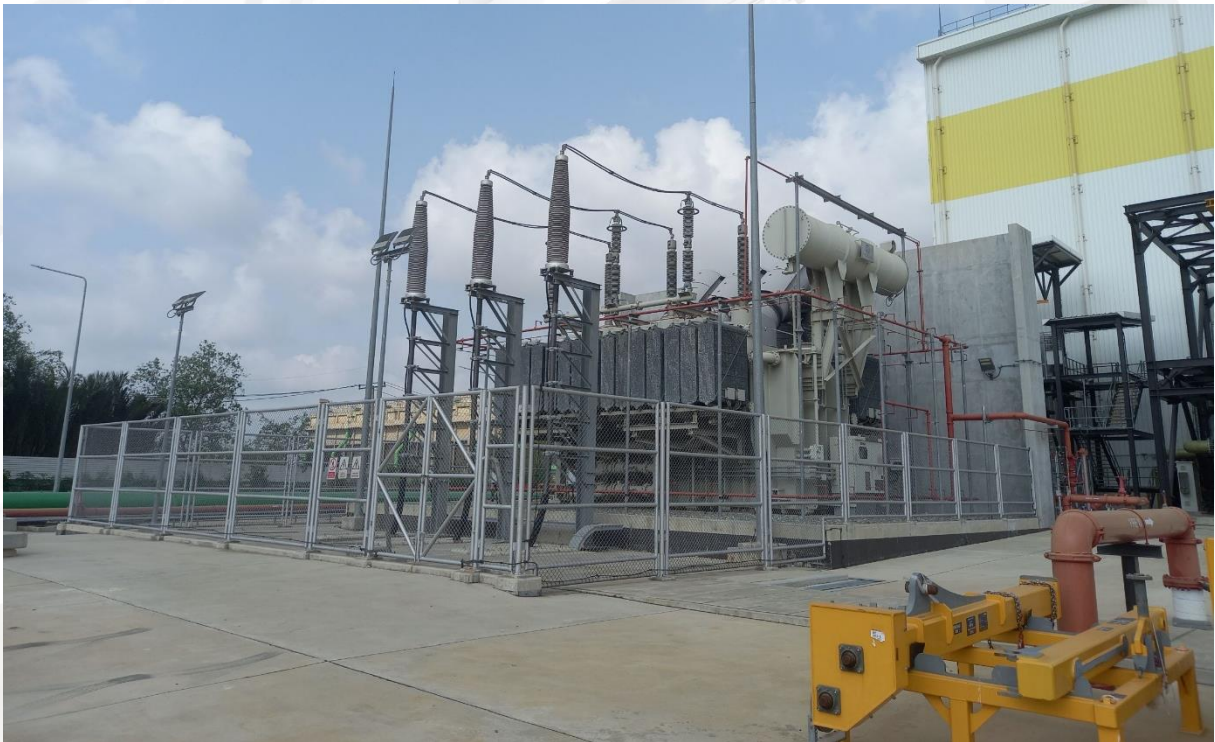
ภาพที่ ๖ หม้อแปลงไฟฟ้า (Generator Transformer) ของหน่วยงานรัฐวิสาหกิจ
