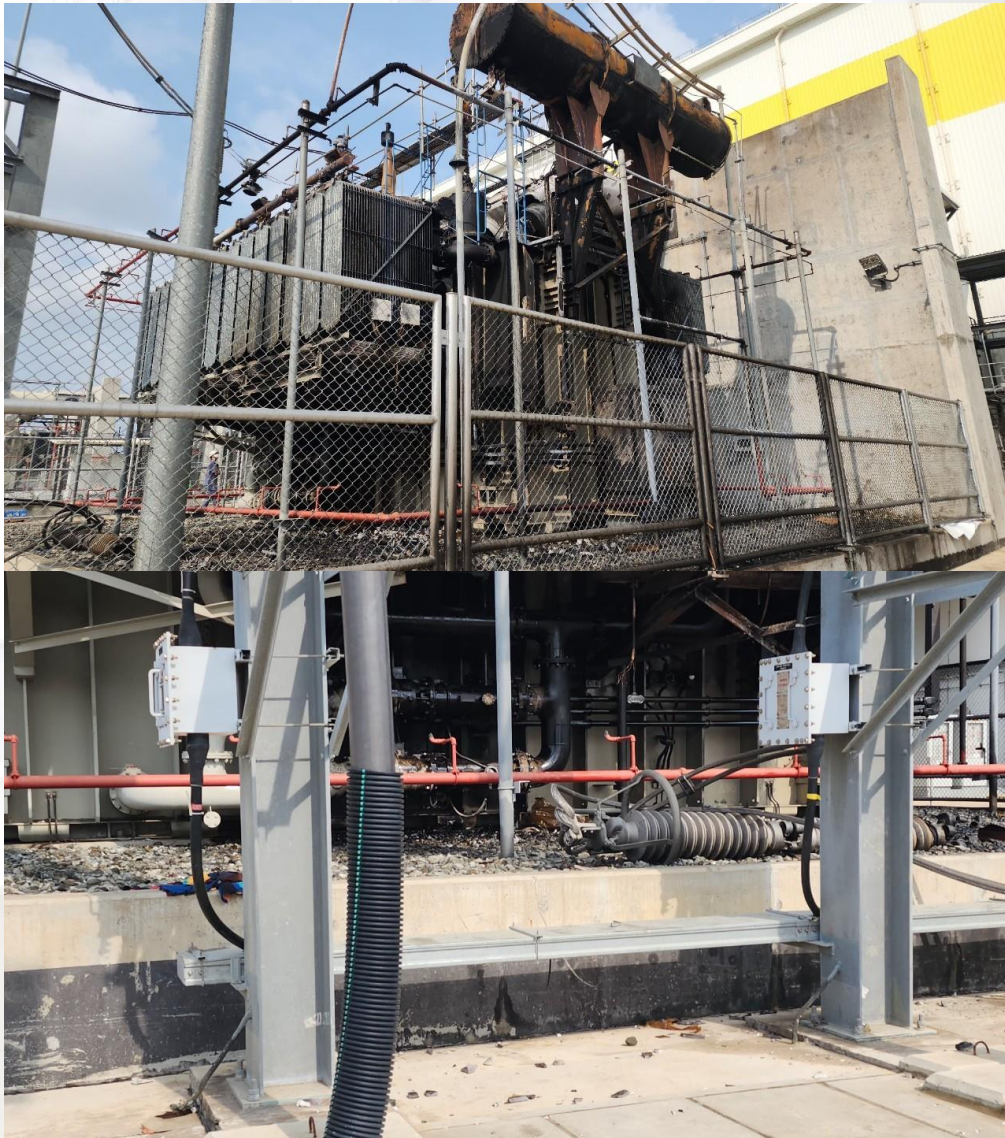
ภาพที่ ๘ ลักษณะทางกายภาพของหม้อแปลงเครื่องหน่วยที่ ๒ ของโรงไฟฟ้าพลังงานความร้อนร่วมโรงชุดที่ ๔ (หม้อแปลงไฟฟ้าเครื่องที่เกิดเหตุ)
