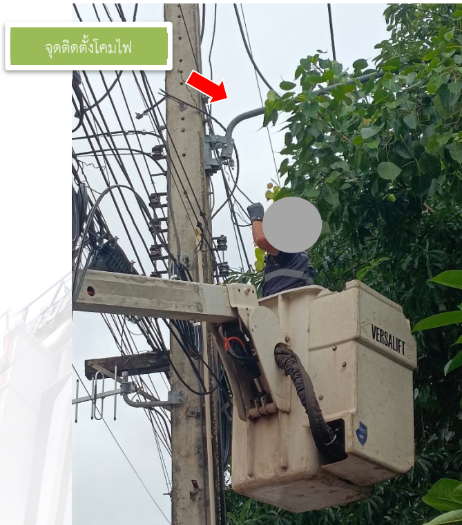
เสาไฟฟ้าที่ระบบแรงต่ำ มีการติดตั้งระบบไฟฟ้าทั้งด้านหน้า และด้านหลังของเสาไฟ ส่วนด้านหลังเสาไฟมีโคมไฟส่องสว่างติดตั้งเพื่อให้แสงสว่างภายในวัด
