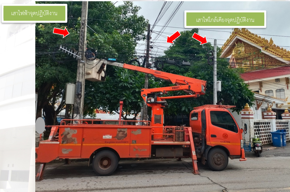
เสาไฟฟ้าใกล้เคียงจุดปฏิบัติงาน ที่มีการเชื่อมไฟฟ้าเข้าโคมไฟส่องสว่าง ซึ่งใช้ระบบจำหน่ายไฟคนละระบบกับจุดปฏิบัติงาน
