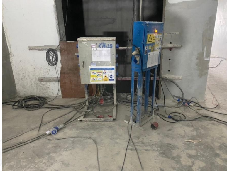
รูปที่ ๖ ตู้ไฟฟ้าสนามที่ใช้ในการปฏิบัติงาน
