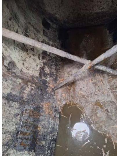
ภาพที่ ๒ ลักษณะภายในถังบรรจุกา
